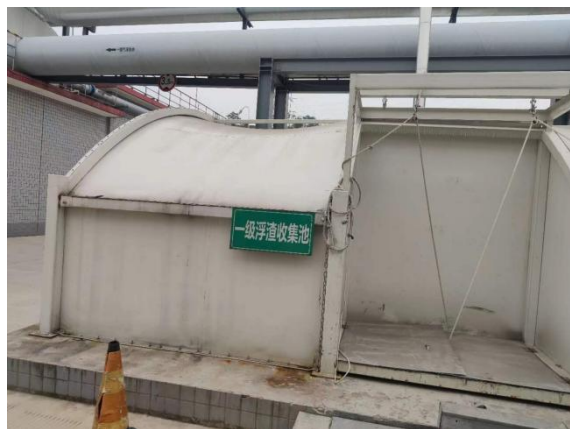
一级浮渣收集池
