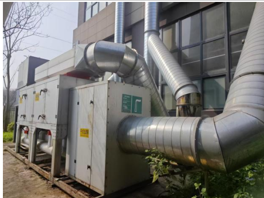
RCO 焚烧炉催化燃烧设施
