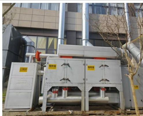
RCO 焚烧炉催化燃烧设施
