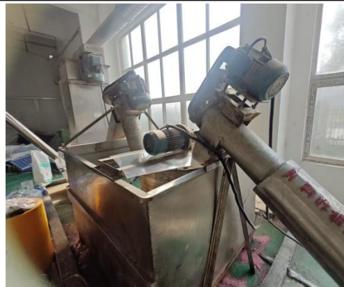
塑料清洗沉淀池
